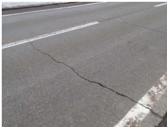
写真-3.2 横断ひび割れ
