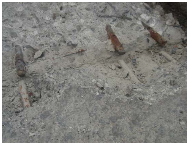
写真-3.1 ダウエルバーの破断
